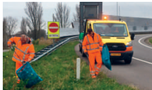
Medewerkers van aannemer de Jong Zuurmond met een rijdende afzetting in de bermen van de afrit S117 (deelgebied 6) aan het schoonmaken op 23 maart 2019.
